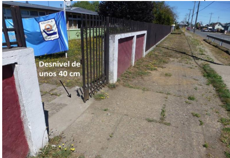
FIGURA N° 7-35 Desnivel topográfico evidente en entrada a escuela de calle Pedro Montt (o ruta U-89).
