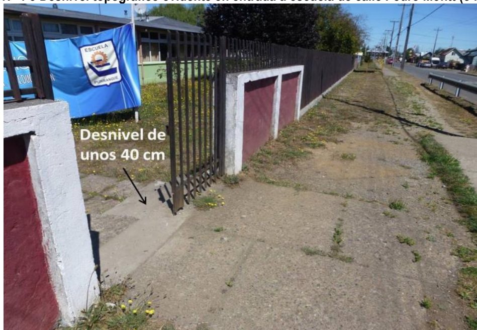
FIGURA N° 4-3 Desnivel topográfico evidente en entrada a escuela de calle Pedro Montt (o ruta U-89).
